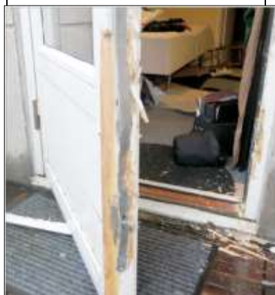
Bild från uppbruten altandörr Hedenhösvägen
